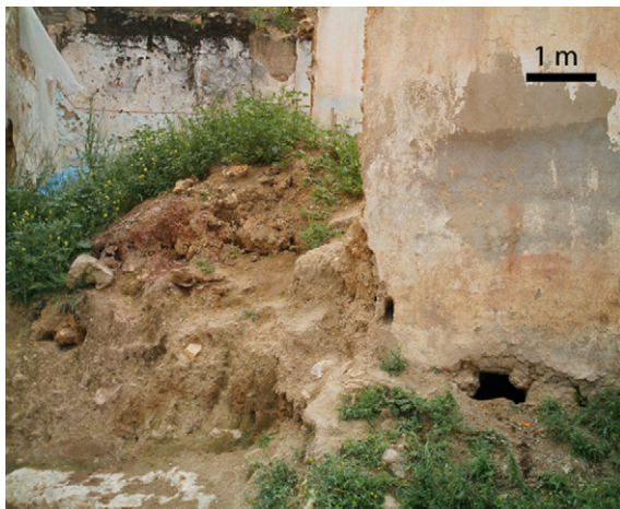
Photo 1. Effondrement engendré par une cavité souterraine. Photo 1. Collapse caused by an underground cavity.
